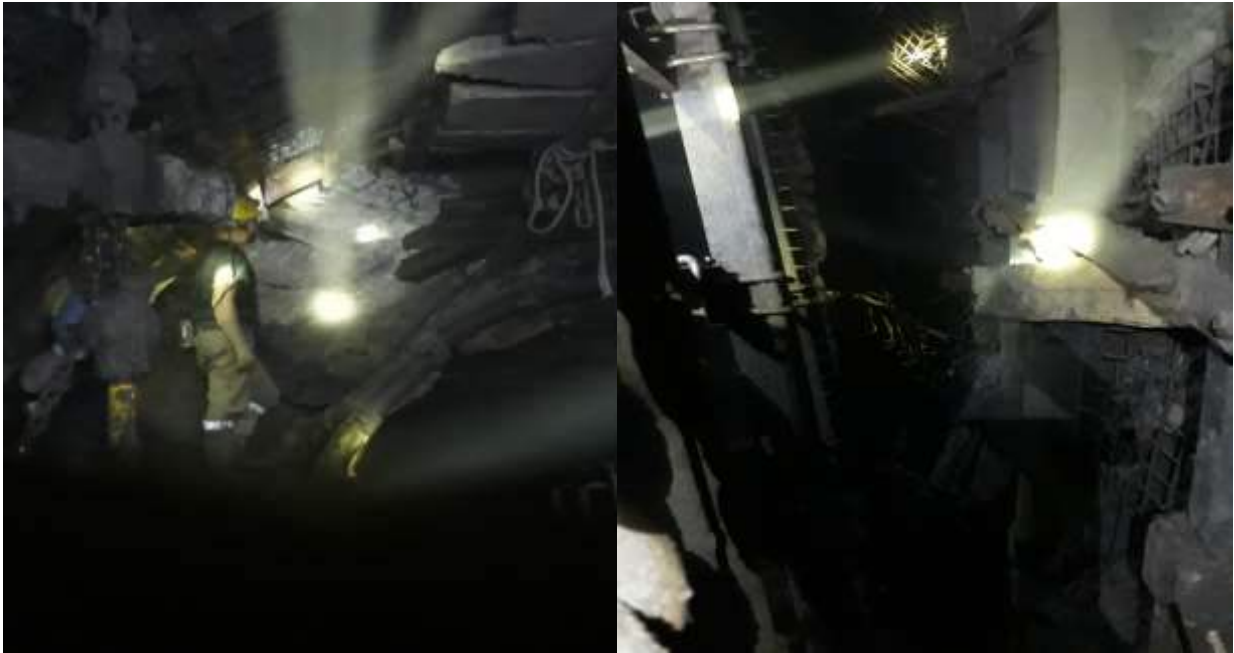
Şekil 5. Deforme olmuş kesitin tekrar şekle sokulması ve dış katman çelik tahkimatın yerleştirilmesi (solda), iç ve dış tahkimatlar ve arasında dolgu uygulaması yapılmadan önce (sağda)
