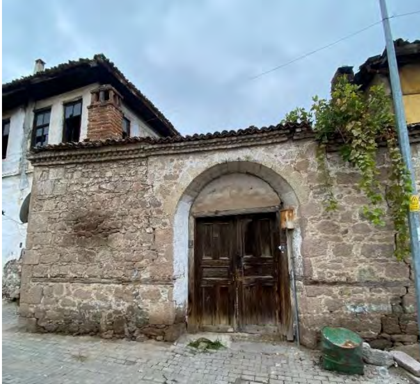
Fotoğraf 9: C Tipi Parsel Düzenine Sahip Yapı Örneği Bahçe Kapısı(Hatice Nur Özkan Arşivi,2020)
