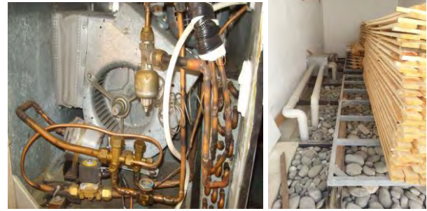
Şekil 4. Nem alma ünitesinin içerisinde sirkülasyon pompası ve evaporatör, Kurutma fırınının iç görünüşü, (Circulating pump inside dehumidification unit and evaporator, Inside view of drying kiln)
