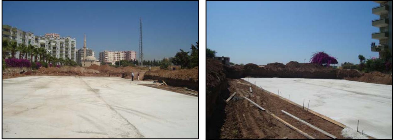
Şekil 10. Zeminde yüzeye oldukça yakın bir şekilde yerleştirilmiş iki ayrı yapı temeli.
