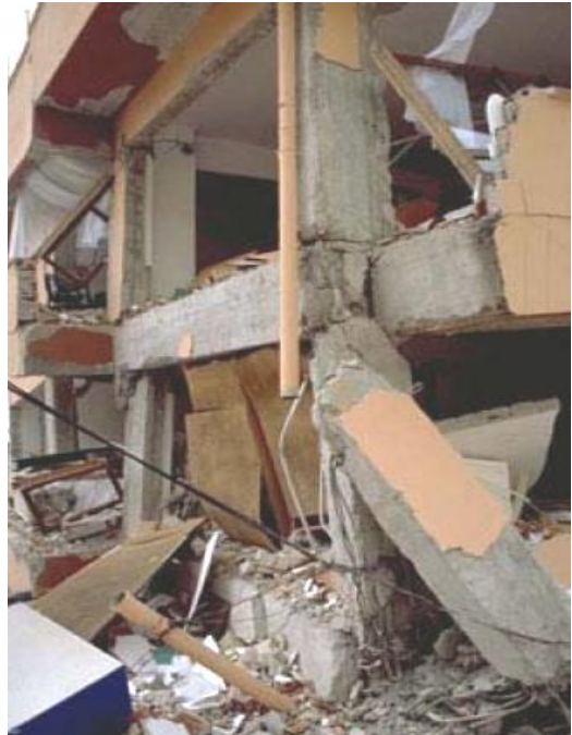
Şekil 2: 1999 Kocaeli depremindeki kolon-kiriş birleşim bölgesi göçmesi [2].
